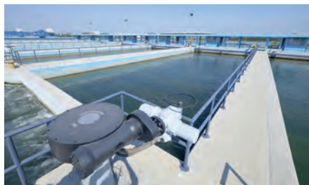
Tratarea apei – filtru de nisip
